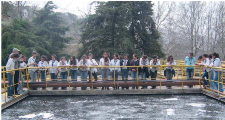
محطة معالجة مياه الصرف الصحي
