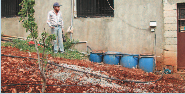
وحدة لمعالجة المياه الرمادية خارج أحد منازل كوكبا، قضاء راشيا
