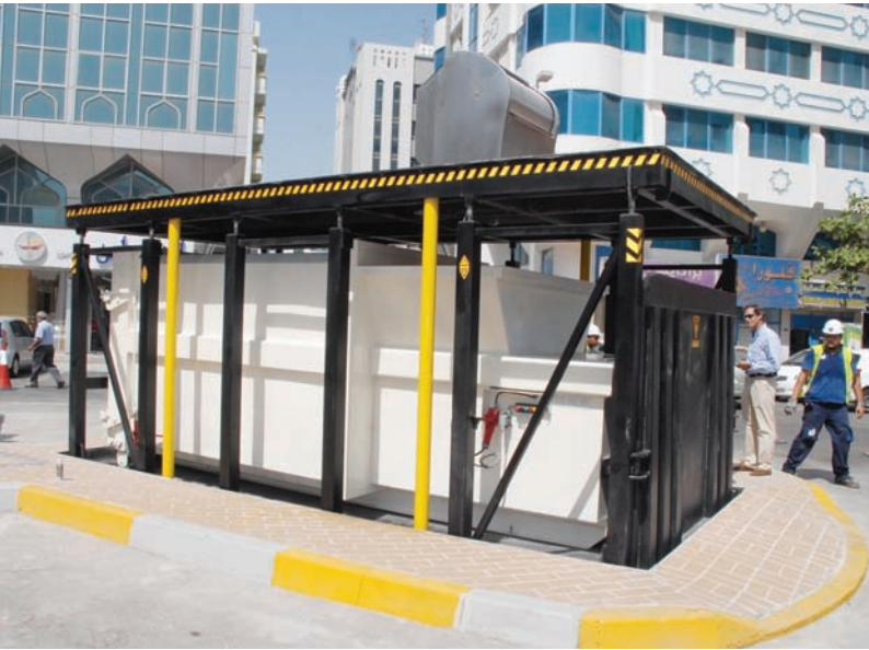
حاويات لجمع النفايات تحت الأرض تم تركيبها حديثاً في أنحاء أبوظبي
