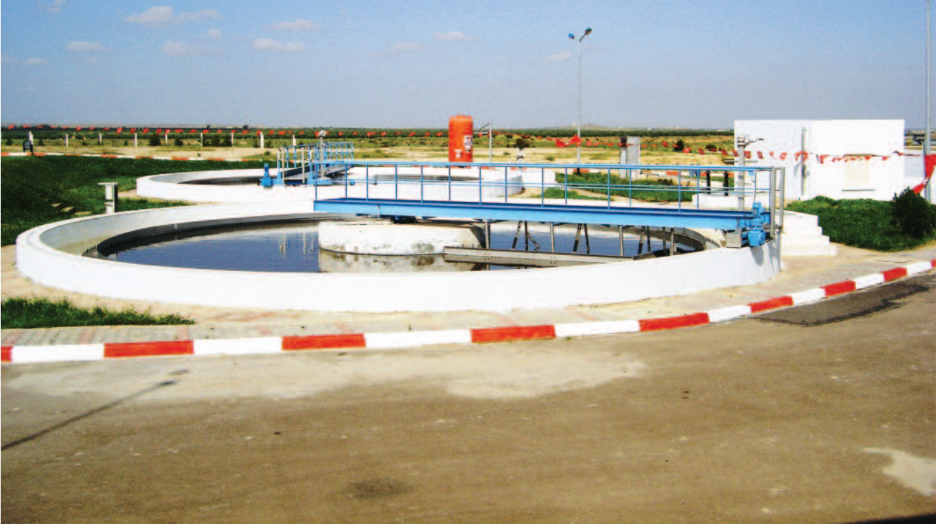
محطة لمعالجة المياه المبتدلة
