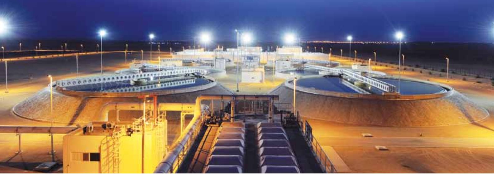
محطة الساد لمعالجة مياه الصرف، حيث يُستخدم الغاز الحيوي (بيوغاز) المنبعث في توليد الكهرباء
