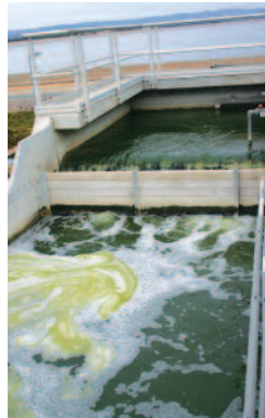
محطة لمعالجة مياه الصرف الصحي
