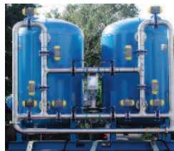
وحدة لمعالجة المياه الصناعية
