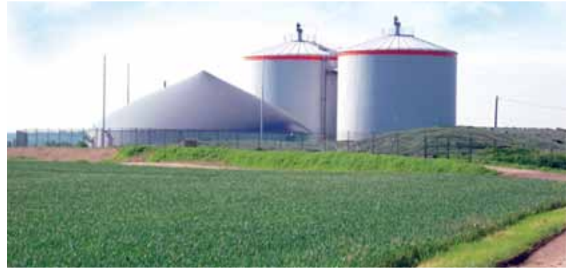
وحدة لإنتاج البيوغاز من النفايات الزراعية والحيوانية في مزرعة قرب بلدة فوكنشتاين في ألمانيا. يتم هضم المواد العضوية لاهوائياً لإنتاج الغاز الحيوي الذي يستخدم لتوليد الطاقة
