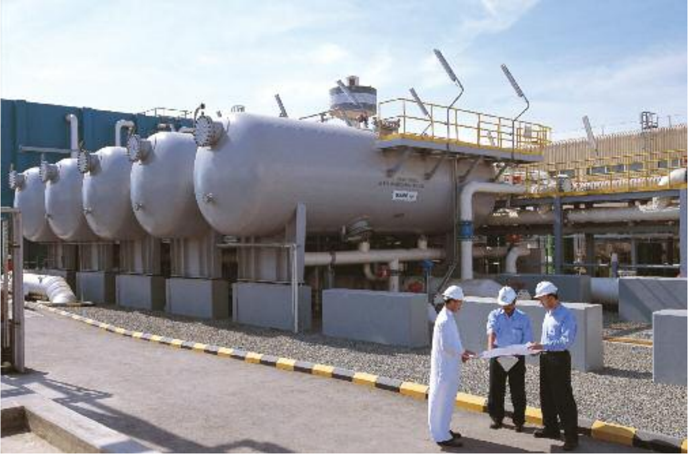
وحدة معالجة مسبقة لمياه البحر في محطة تحلية
