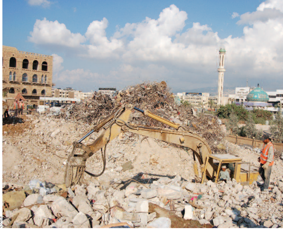
مكب للنفايات الصلبة تم استحداثه في برج البراجنة، إحدى ضواحي بيروت الجنوبية، لاستقبال أنقاض الأبنية المدمرة
