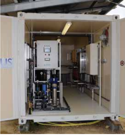
وحدة معالجة مياه الصرف
