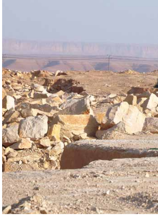
معدات في موقع لاقتلاع الصخور حيث يتم تجريف الأرض وتغيير معالمها الطبوغرافية وتخریب نظامها الحيوي
