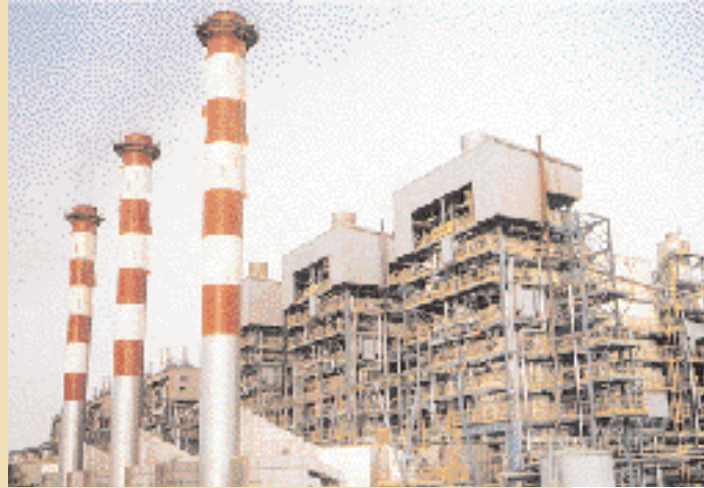
محطة لتحلية مياه البحر في جبل علي، الإمارات
