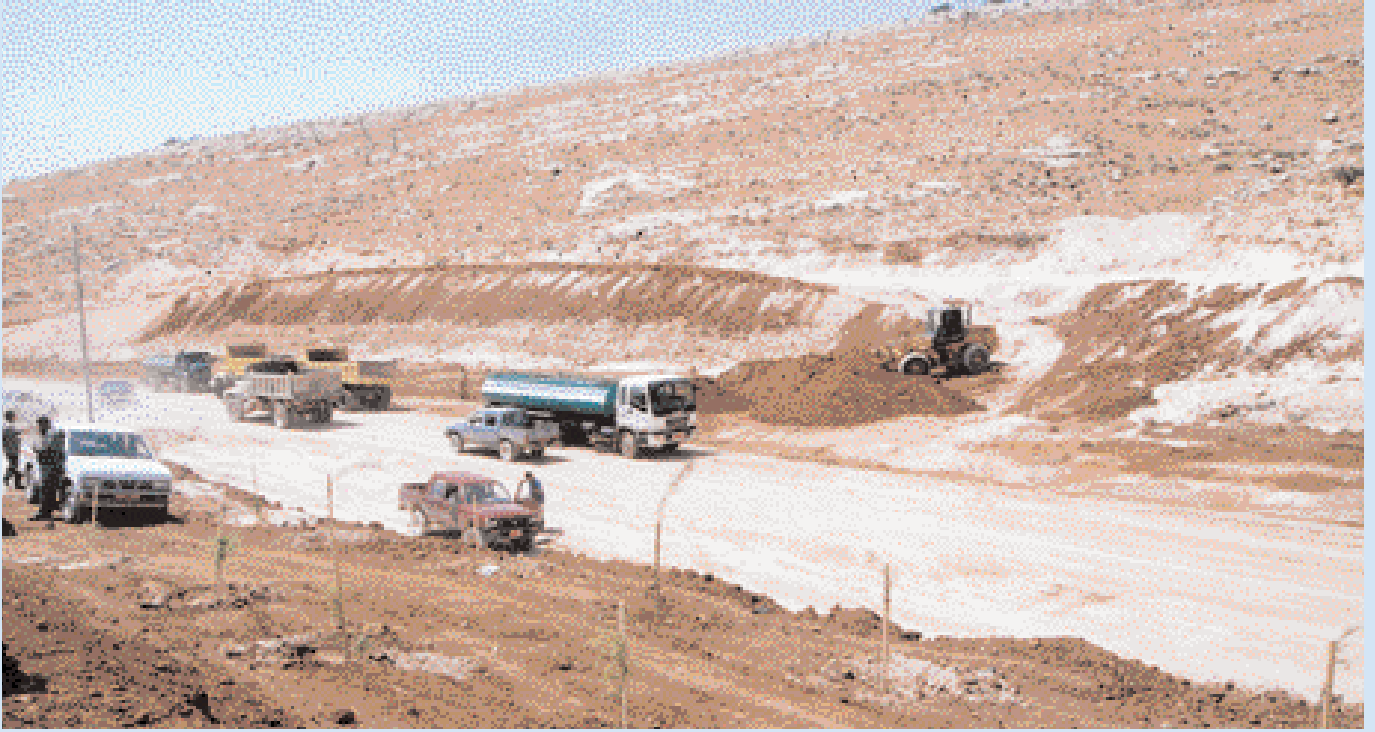
آليات تعمل على إعادة تاهيل كسارات ياجوز وانشاء "غابة الوفاء" في الموقع
