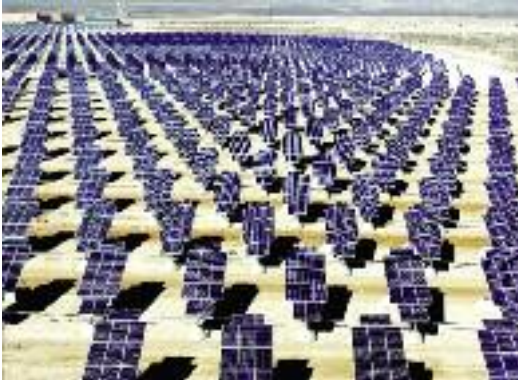
محطة فوتوفولطية لإنتاج كهرباء من الطاقة الشمسية
